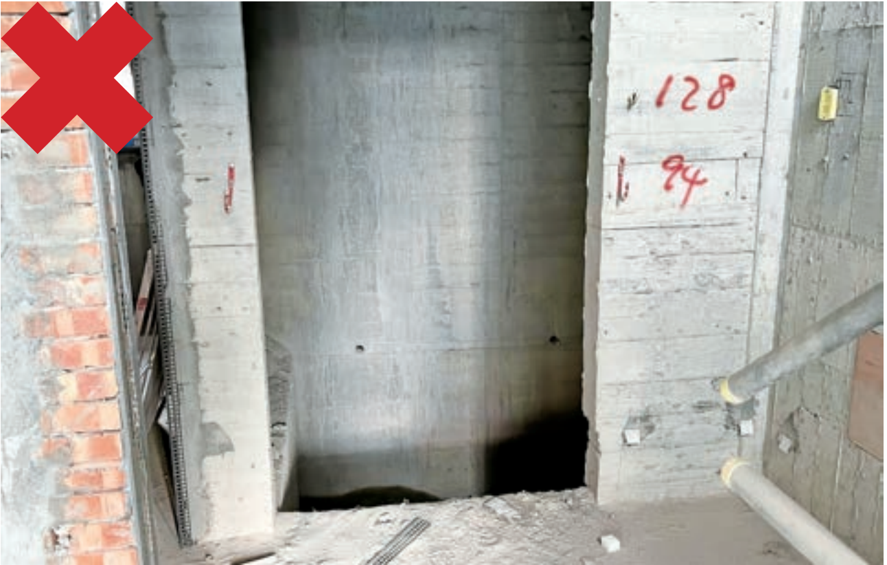
圖 16 電梯坑井開口未設護欄
