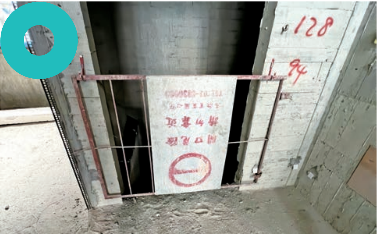
圖 17 電梯坑井開口已設活動式護欄（警告標示用語誤反置）
