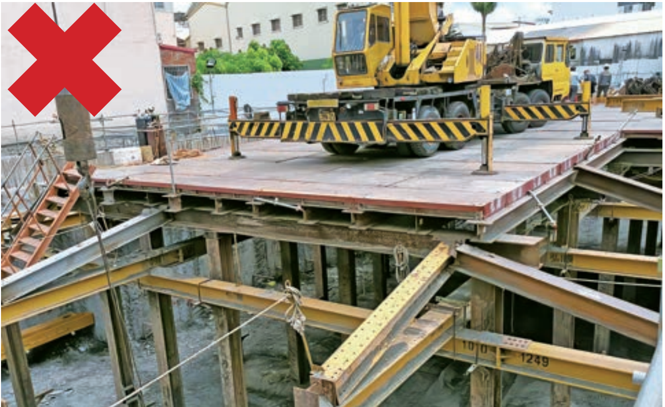
圖 11 高差 2 公尺以上施工構台開口邊緣未設護欄 (錯誤例)
