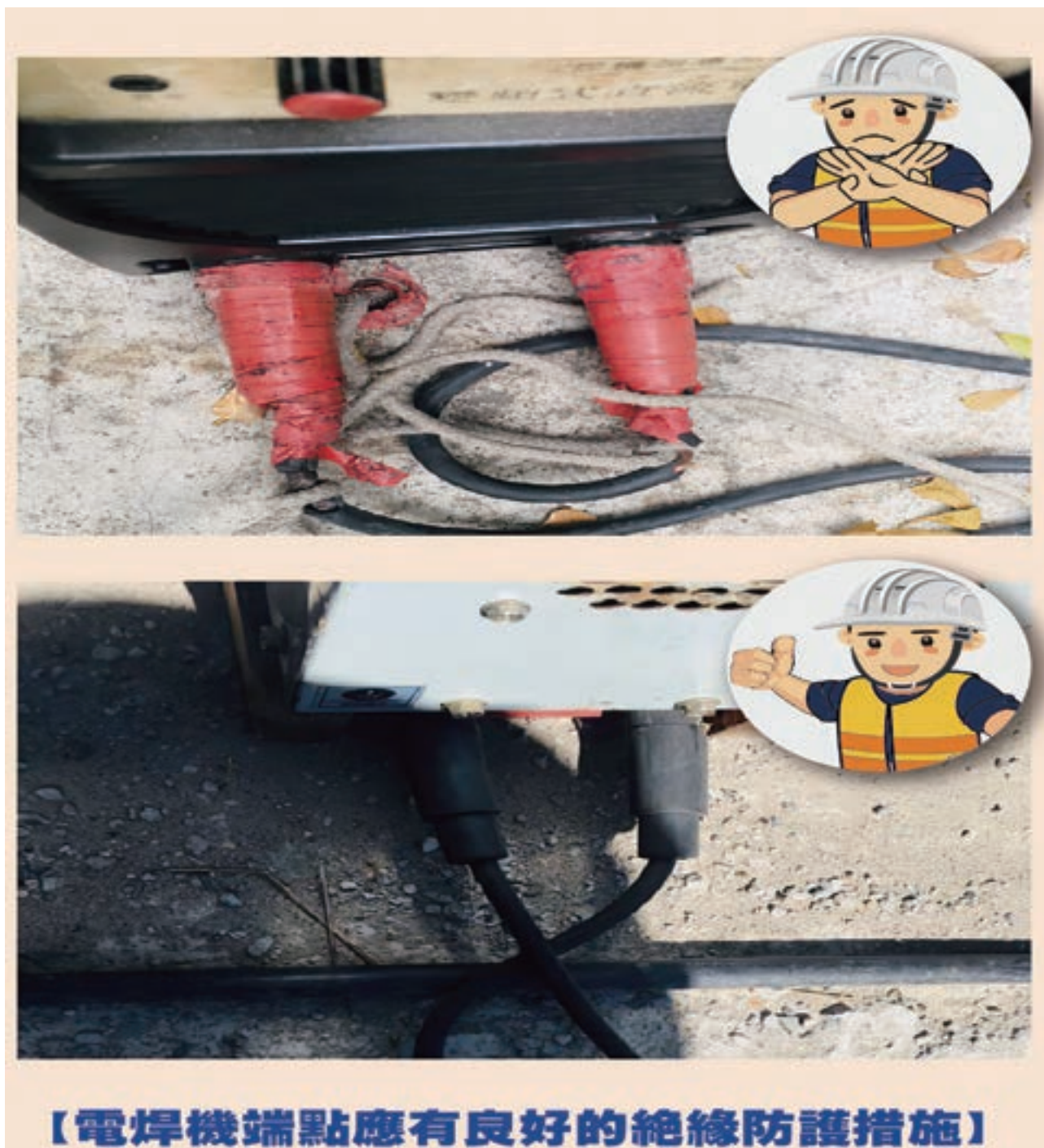
圖 24 電焊機端點應有良好的絕緣防護
