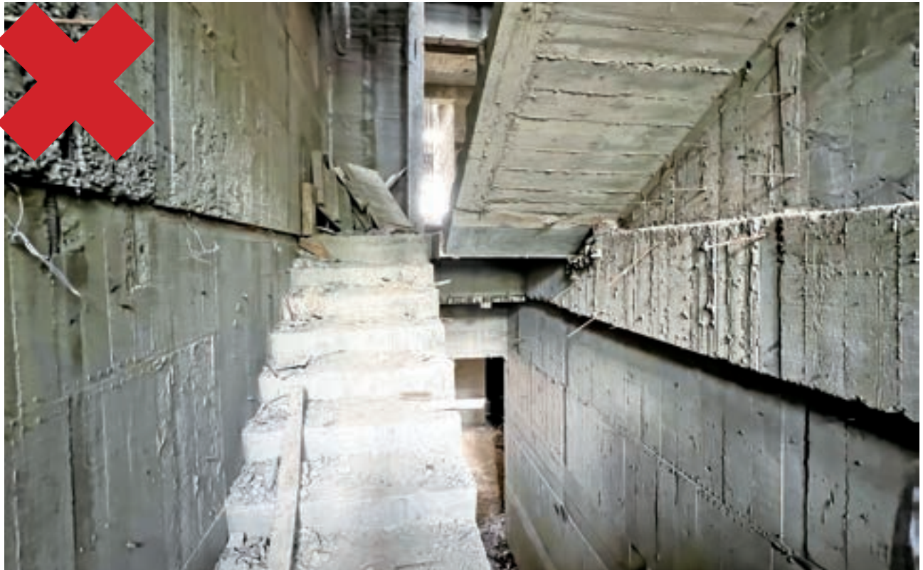
圖 19 構造物樓梯未設護欄
