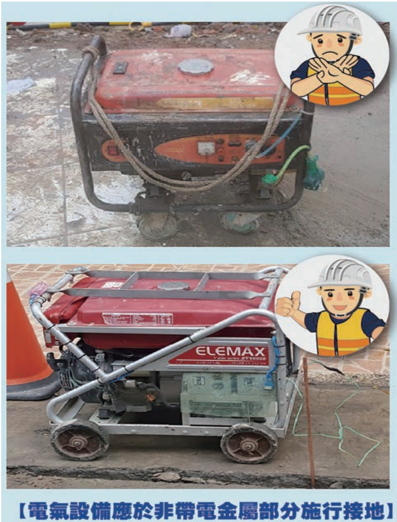
圖 25 電氣設備應於非帶電金屬部分實施接地
